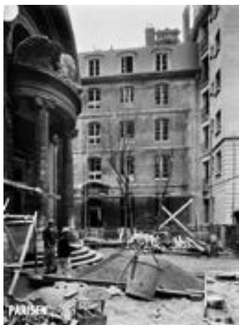
< Строительство жилого комплекса «Карм Политекник» типологии «Бон Марше» (слева – церковь Св. Ефрема Сирина, в середине – здание XVII века, справа – новые здания 1930-х гг. Автор: ARR / Construction of the HBM Carmes Polytechnique ( left the church Saint-Éphrem-le-Syriaque, middle the 17th century building, right the new 1930 buildings). Author: ARR.
