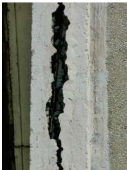
< Рис.3. Жилой дом серии 1-335с в Ангарске. Разрушение торцевой стены: расслоение стеновых панелей (слева); торцевая панель на уровне 4-го этажа (справа)
