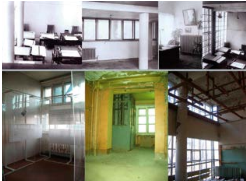
> Интерьеры дома Наркомфина на Новинском бульваре. Начало 1930-х годов и 2011 год. Батареи отопления не сохранились
