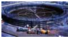
Рис 2. LNG, резервуар, газовая компания, Осака
