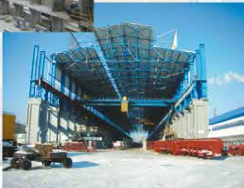
г. Шелехов, ИркАЗ корпус электролиза
