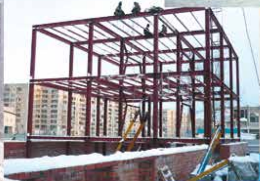
г. Шелехов, ИркАЗ корпус электролиза
