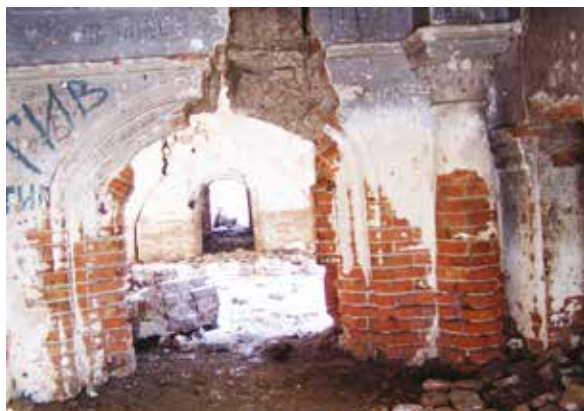
Разрушающаяся трапезная Фрагмент интерьеров
