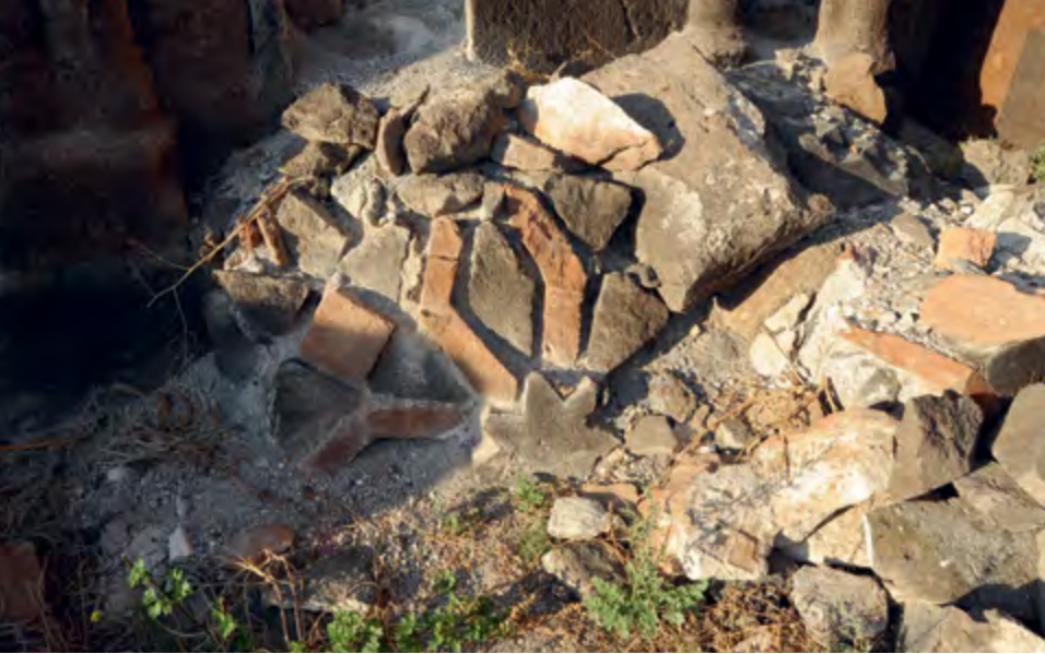
^ Рис. 4. Ани. Гавит церкви Апостолов. Упавший фрагмент перекрытия. Фото А. Казаряна. 2015
