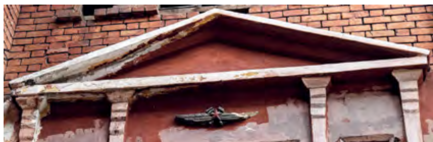
v Фрагмент декоративного оформления дворового фасада главного здания кадетского училища. Наличник оконных проемов с эмблемой ВВС
