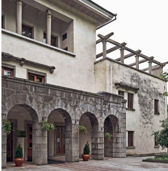
> Рис. 14. Санаторий в Нижней Ореанде. Корпус № 2. Вид с севера (слева), вид с юга (справа). Арх. М. Я. Гинзбург и Ф. И. Михайловский. 1945–1948. Фото Н. Васильева
