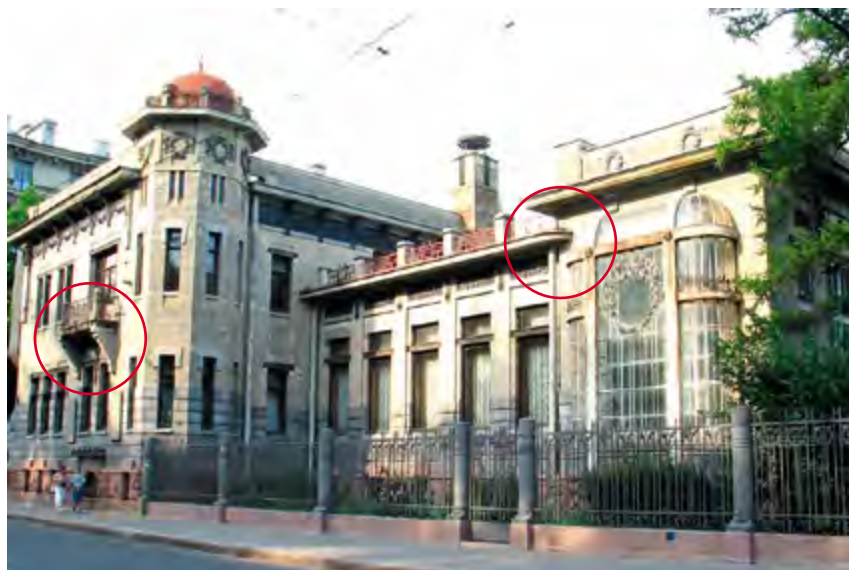
^ Рис. 8. Особняк М. Кшесинской в Санкт-Петербурге (1904–1906 гг.) архитектора Александра фон Гогена. Современный вид. На фотографии обозначены балкон и карниз с водосливом, проходящим сквозь карнизную плиту
