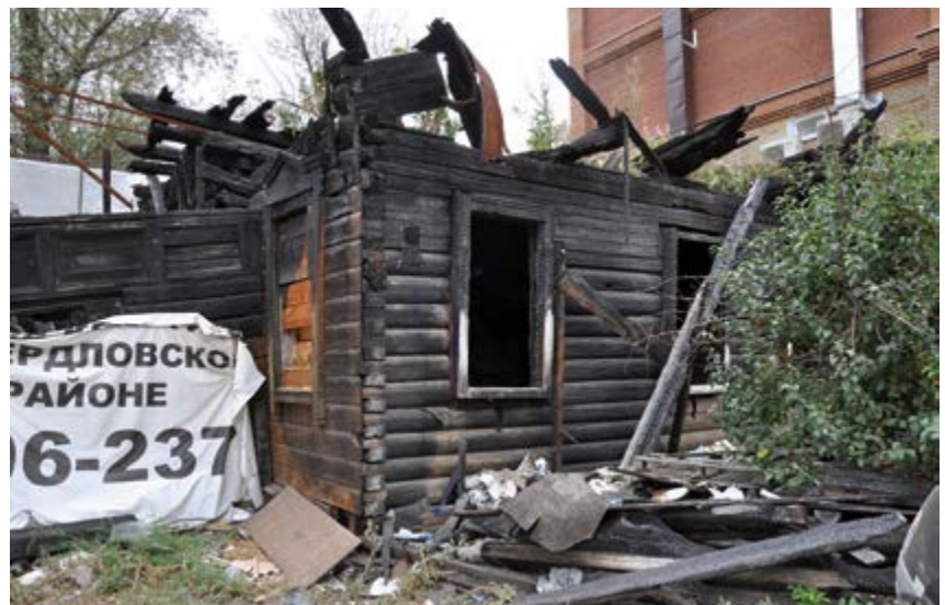
v Памятник деревянной архитектуры в квартале 93 после пожара (ул. Дзержинского, 8)
