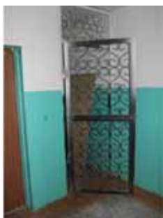
4 Рис. 13. Устройство контейнеров для хранения овощей на лестничной площадке многоквартирного жилого дома. Иркутск, 2012 г.
