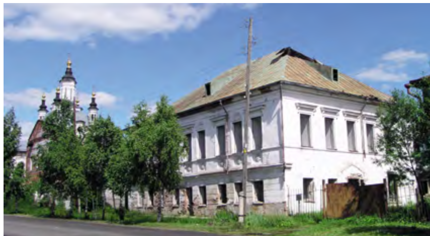
Рис. 8. Бывший дом Шохина по ул. Хохрякова, 2а, < а – состояние объекта в 2006 v б, в – фрагменты интерьера (2006). Фотографии А. И. Клименко
