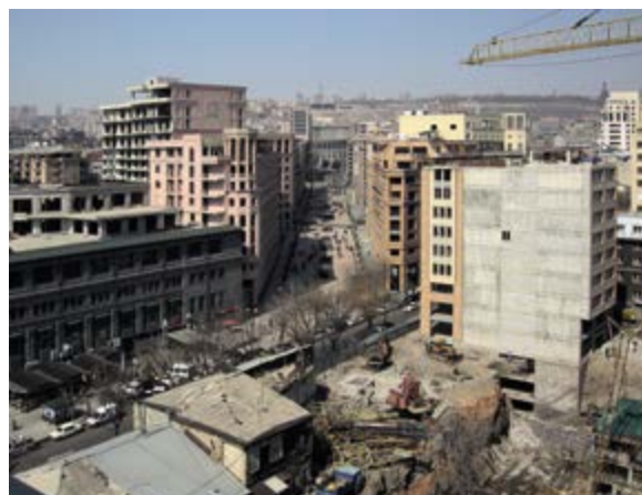
< Рис. 22. Ереван. Разрушение остатков вернакулярной застройки на пути Северного проспекта. В перспективе проспекта – Опера (почти не видна). Фото автора, 2012
